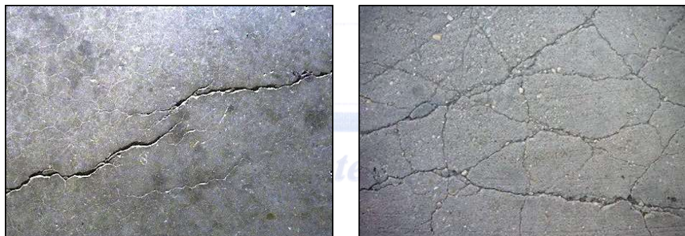
Gambar 4: Cacat beton shrinkage , yaitu penyusutan yang terjadi pada beton akibat penguapan air yang berlebihan.
