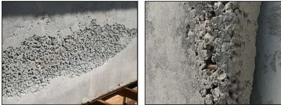
Gambar 2: Adukan beton kekurangan agregat halus. Terdapat rongga-rongga pada adukan ( honey combing ), karena tidak cukupnya pasta dan pasir mengisi rongga tersebut.
