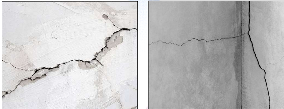
Gambar 3: Cacat beton rangkak, yaitu penyusutan yang terjadi pada beton akibat pembebanan yang berlebihan.
